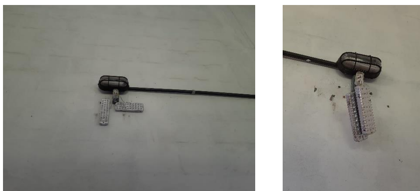
Figura 4: Iluminação de emergência.
