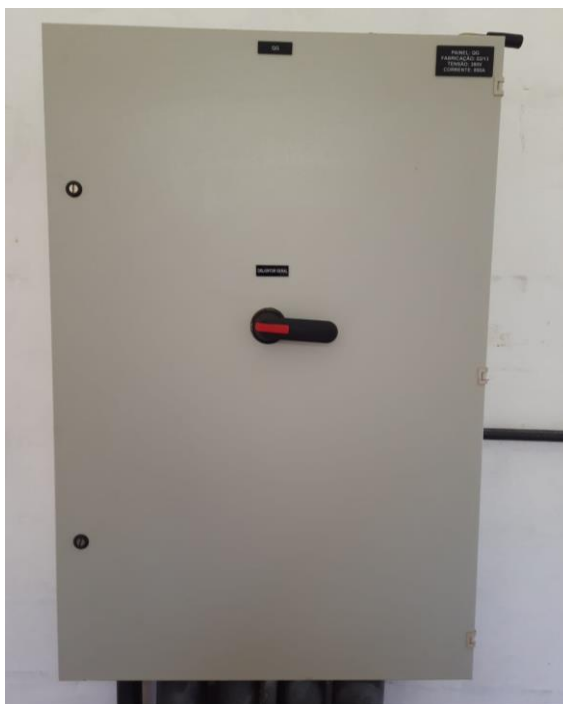
Figura 5: QGBT vista externa.
