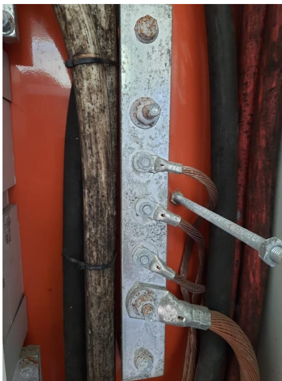
Figura 10: Estado do barramento de terra e parafusos do QGBT.
