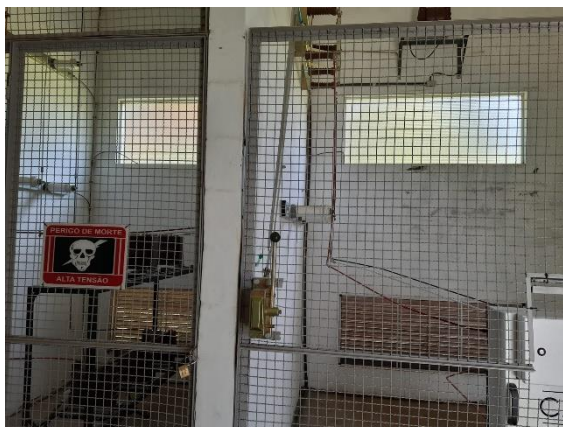
Figura 11: Falta de placa de advertência na chave seccionada "Não Opere Sob Carga".
