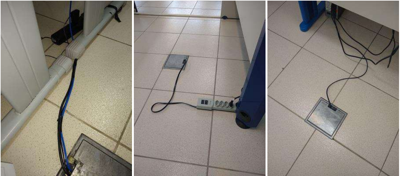
Figura 55 – Fiação passando pelo piso sem proteção.
