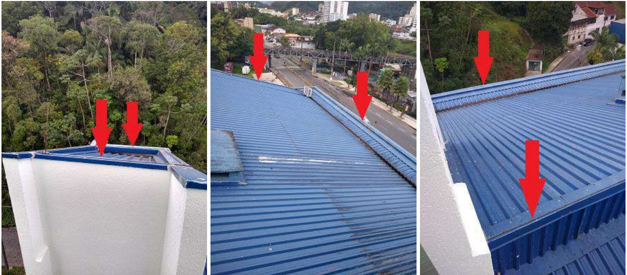
Figura 1 – Anel de captação através de barra chata de alumínio no perímetro da edificação.
