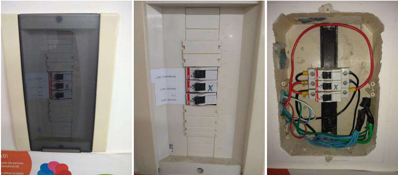
Figura 29 – Quadro de distribuição QD12 – Pavimento 2º tipo.
