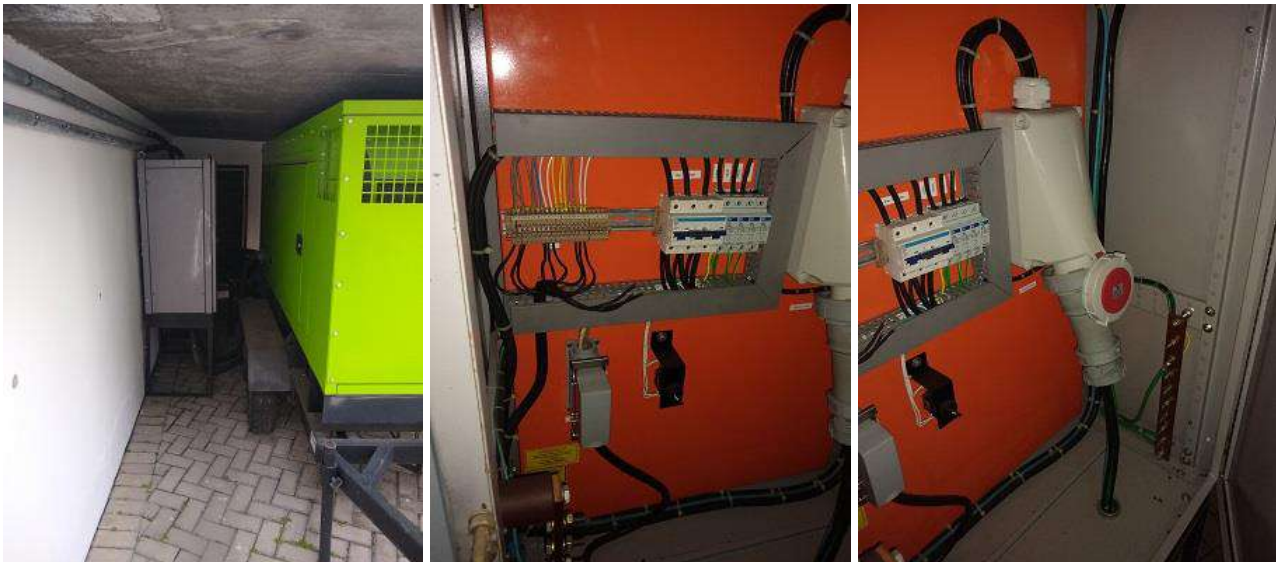
Figura 41 – Quadro de conexão do gerador QD26 – Área externa.
