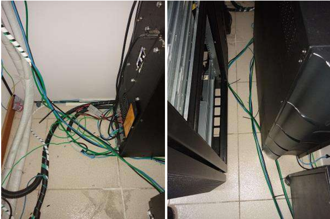
Figura 57 – Fiação exposta no piso do CPD.
