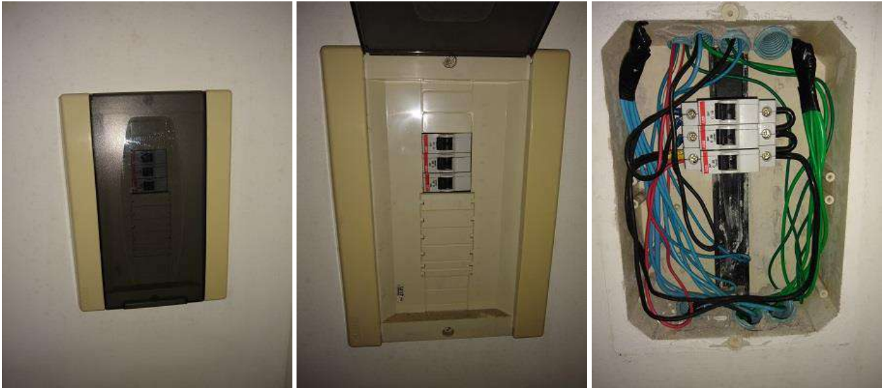
Figura 16 – Quadro de distribuição QD7 – Pavimento 1º tipo.
