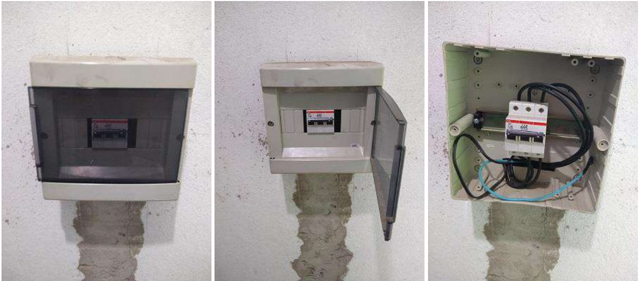
Figura 39 – Quadro QD23 - Alimentação do quadro “QD-Elevador” – Pavimento cobertura.
