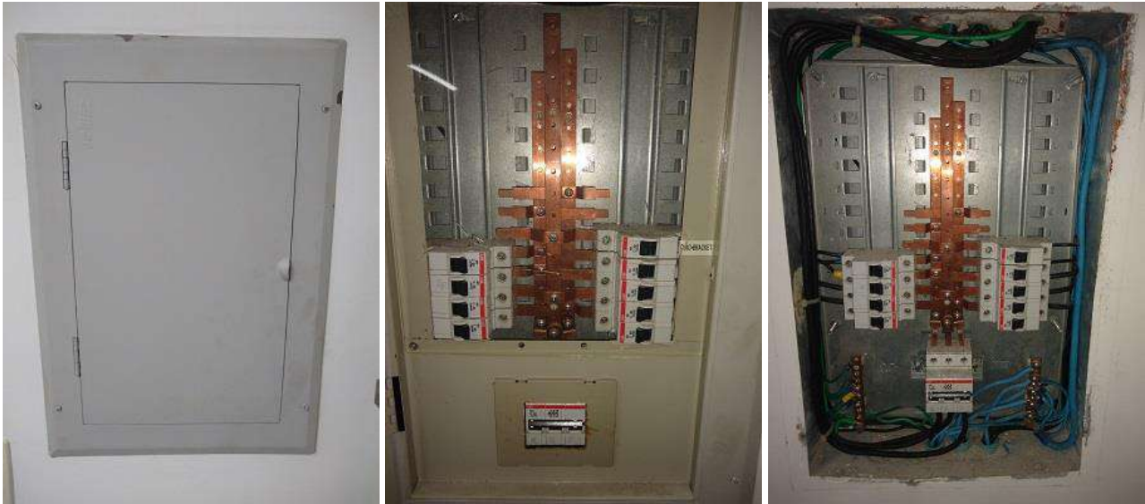
Figura 32 – Quadro de distribuição QD6 – Pavimento 3º tipo.
