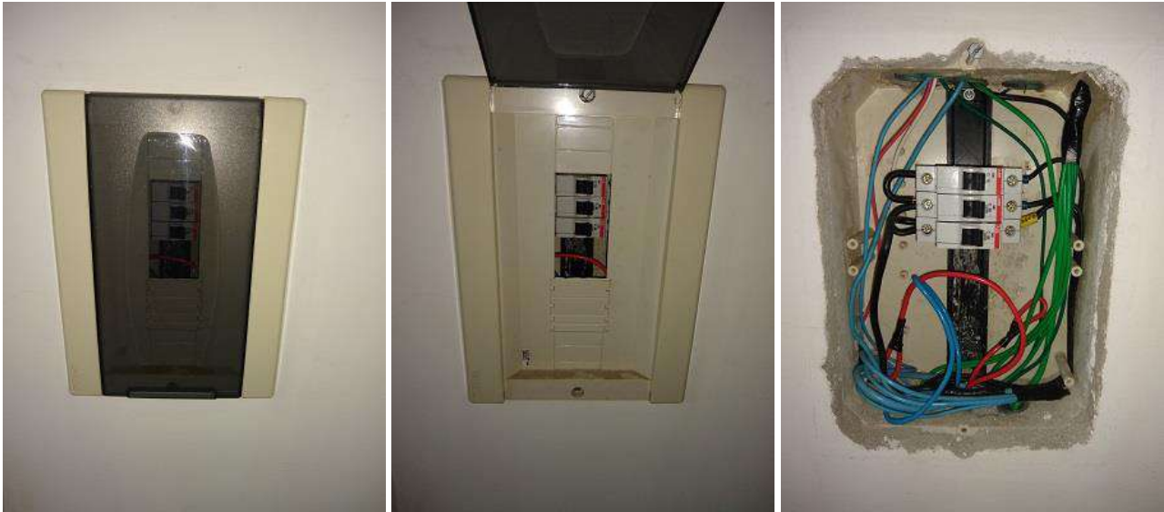
Figura 14 – Quadro de distribuição QD10 – Pavimento 1º tipo.
