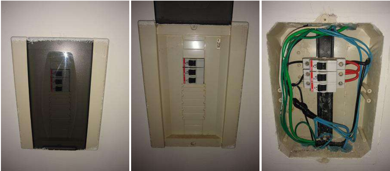
Figura 34 – Quadro de distribuição QD20 – Pavimento 3º tipo.
