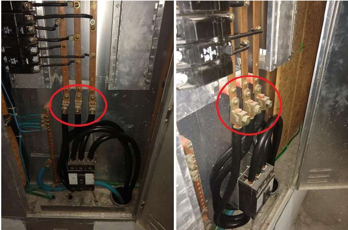
Figura 4 – Conectores dos barramentos de fase.
