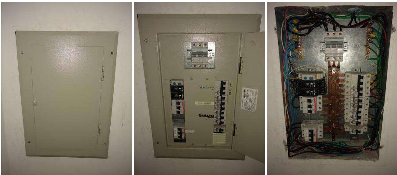
Figura 9 – Quadro de distribuição QD1 – Pavimento mezanino.
