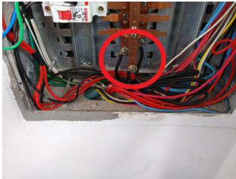
Figura 7 – Circuito ligado diretamente no barramento de fase sem disjuntor fazendo sua proteção.
