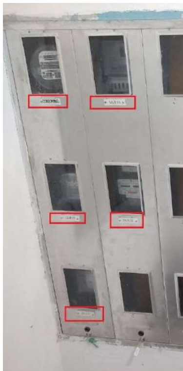
Figura 2 – Identificação dos medidores no quadro.
