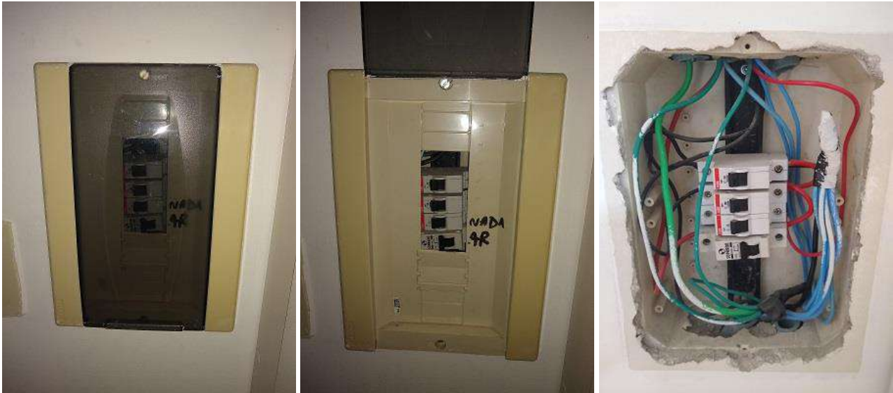
Figura 36 – Quadro de distribuição QD17 – Pavimento 3º tipo.
