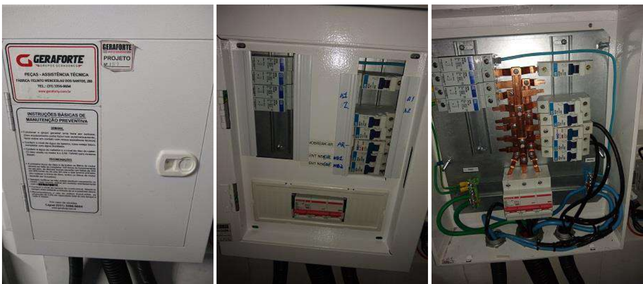
Figura 18 – Quadro de distribuição entrada nobreak – CPD – Pavimento 1º tipo.
