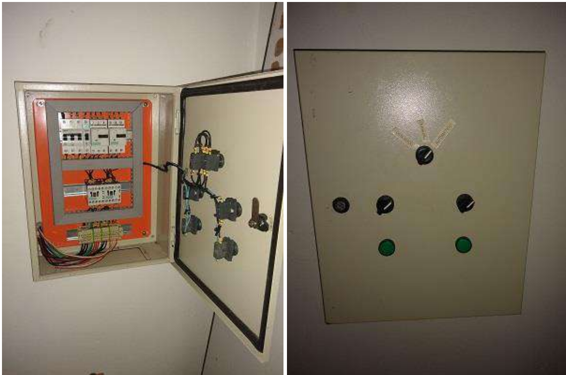
Figura 10 – Quadro de comando das bombas da cisterna QD25 – Pavimento mezanino.
