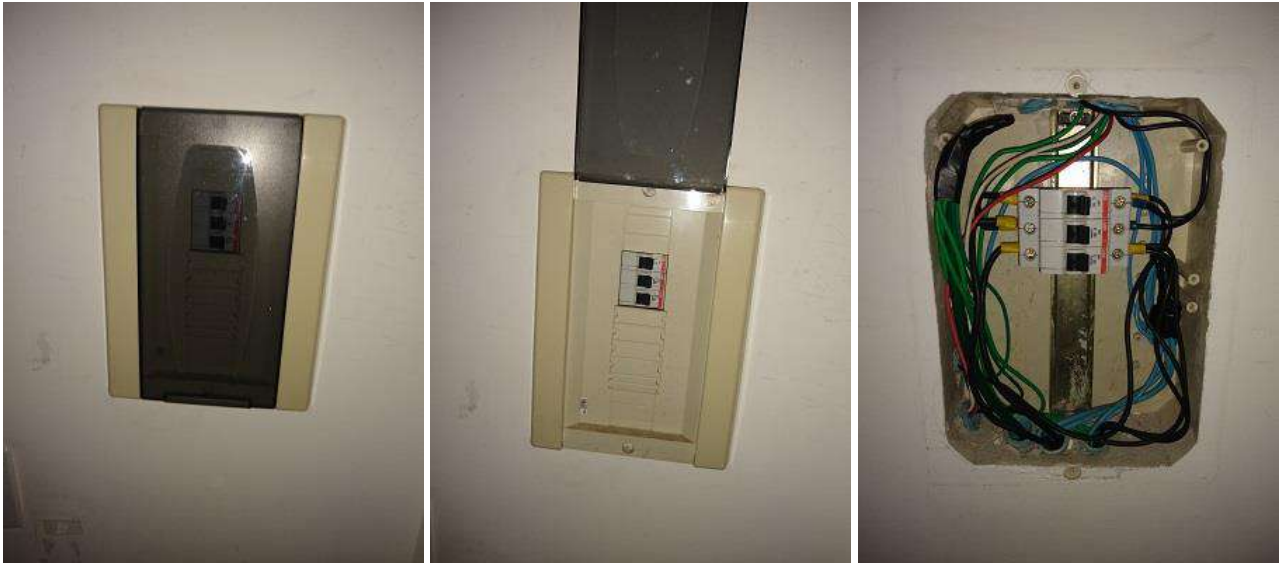
Figura 13 – Quadro de distribuição QD9 – Pavimento 1º tipo.
