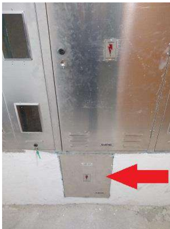
Figura 4 – Quadro BEP instalado abaixo do quadro de medidores.
