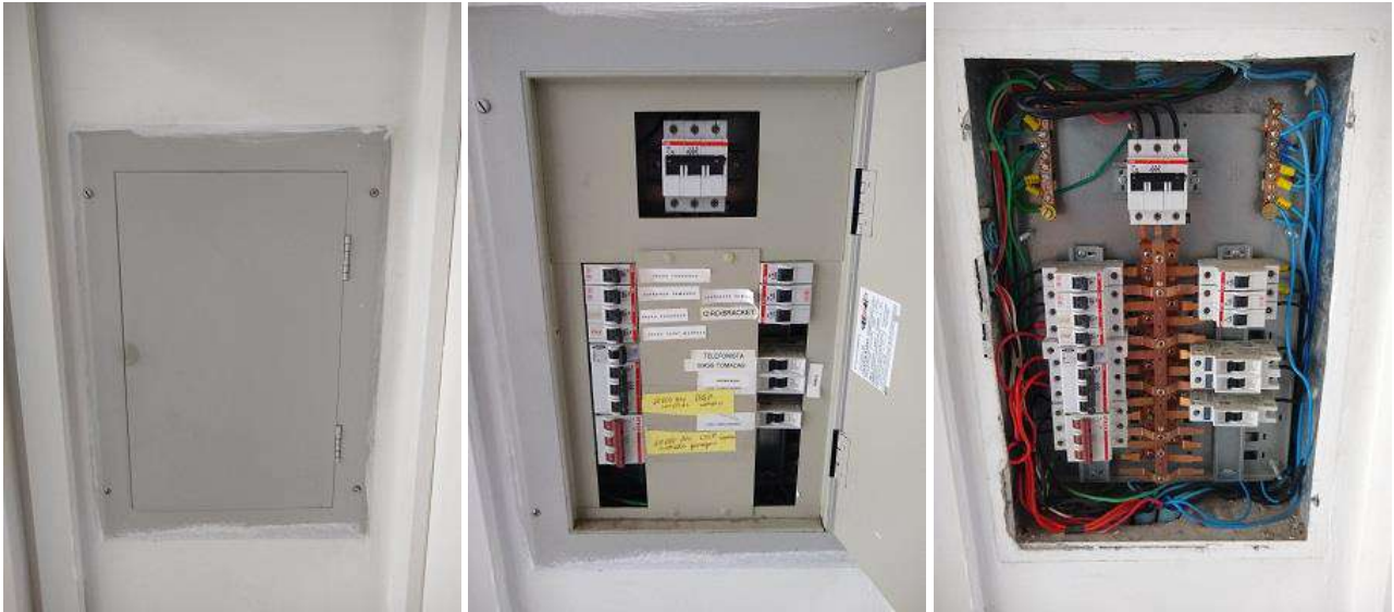
Figura 5 – Quadro de distribuição QD2 – Pavimento térreo.
