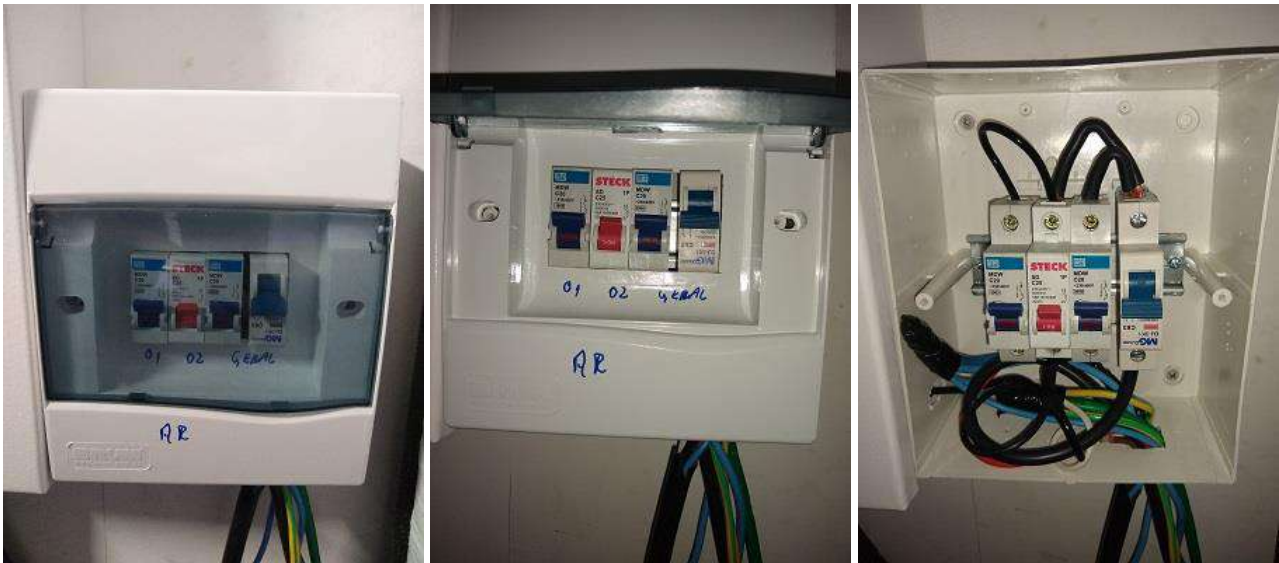
Figura 22 – Quadro de distribuição ar condicionado – CPD – Pavimento 1º tipo.
