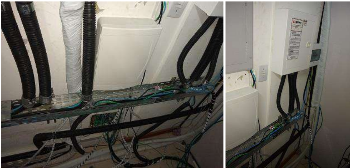
Figura 51 – Eletrocalha do CPD com fiação desorganizada e exposta.
