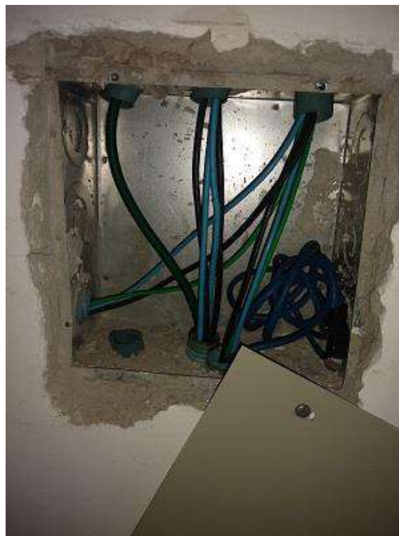
Figura 45 – Presença de detritos e poeira na área interna da caixa.
