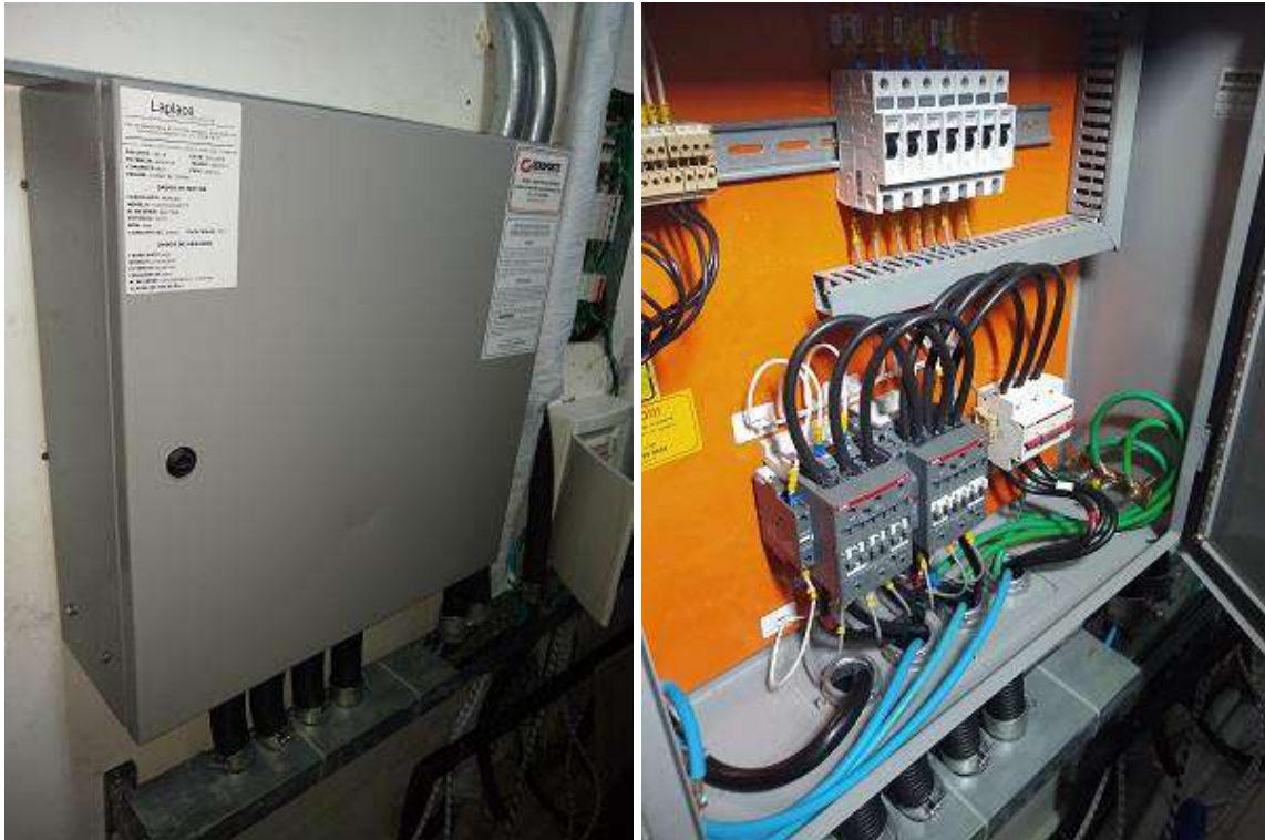
Figura 23 – Quadro de transferência automática QTA – CPD – Pavimento 1º tipo.
