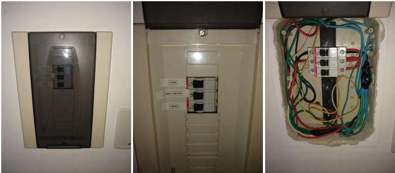
Figura 37 – Quadro de distribuição QD18 – Pavimento 3º tipo.
