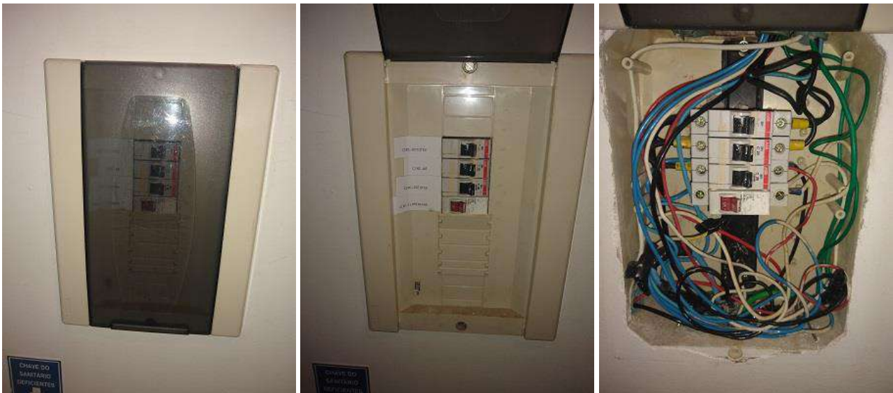
Figura 26 – Quadro de distribuição QD14 – Pavimento 2º tipo.
