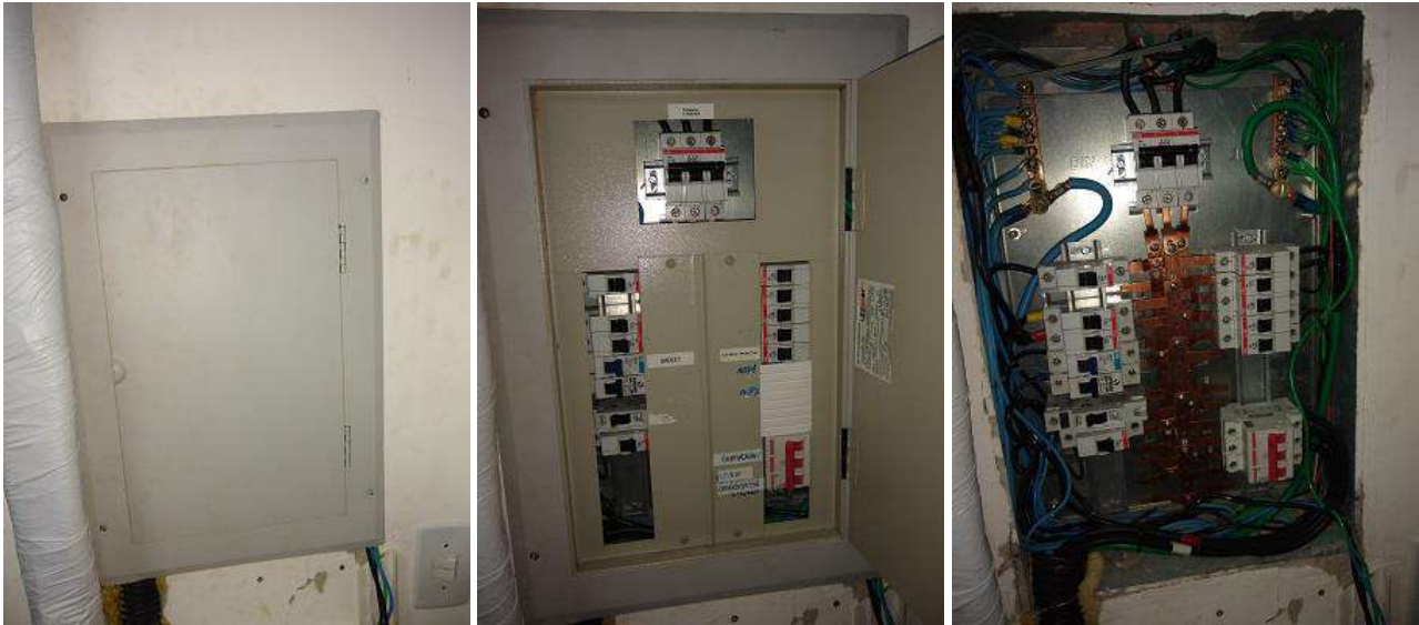
Figura 12 – Quadro de distribuição geral – Pavimento 1º tipo.
