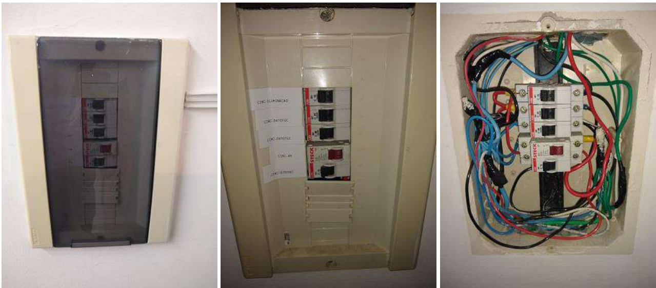
Figura 31 – Quadro de distribuição QD13 – Pavimento 2º tipo.
