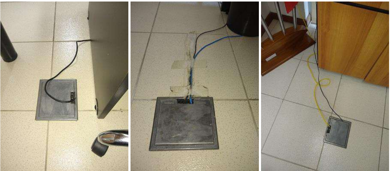
Figura 56 – Fiação passando pelo piso sem proteção.
