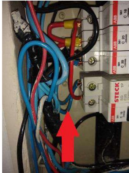
Figura 30 – Fio com isolamento na cor azul sendo utilizado em um circuito de fase.
