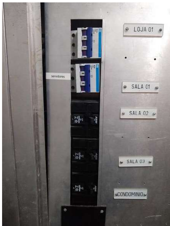
Figura 1 – Identificação dos disjuntores no quadro de medidores.
