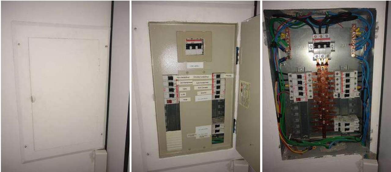
Figura 24 – Quadro de distribuição QD5 – Pavimento 2º tipo.
