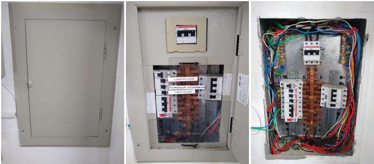
Figura 8 – Quadro de distribuição QD3 – Pavimento mezanino.
