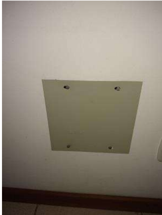
Figura 46 – Caixa sem sinalização de advertência.
