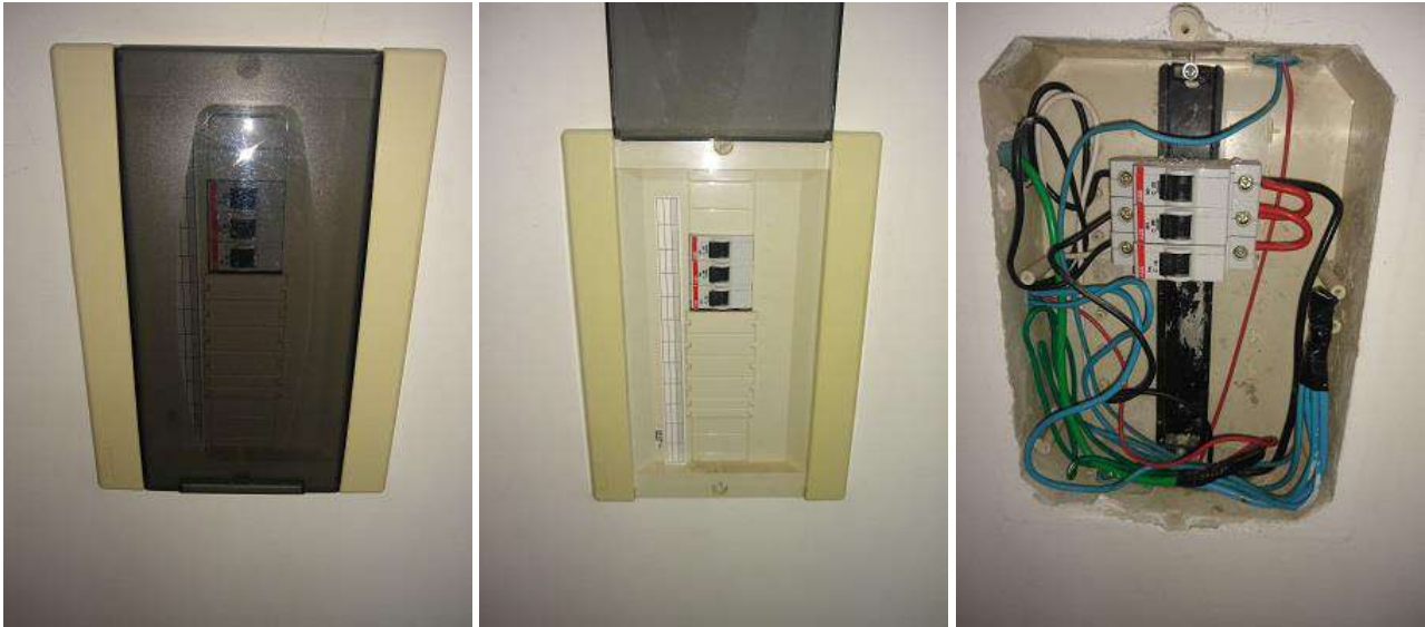
Figura 35 – Quadro de distribuição QD21 – Pavimento 3º tipo.
