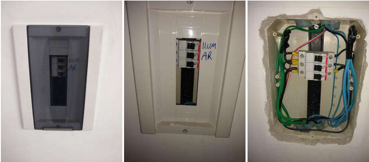
Figura 17 – Quadro de distribuição QD8 – Pavimento 1º tipo.
