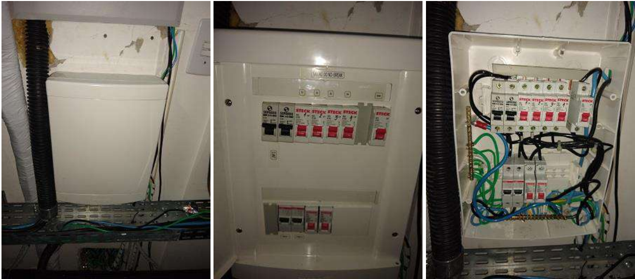
Figura 20 – Quadro de distribuição saída nobreak – CPD – Pavimento 1º tipo.
