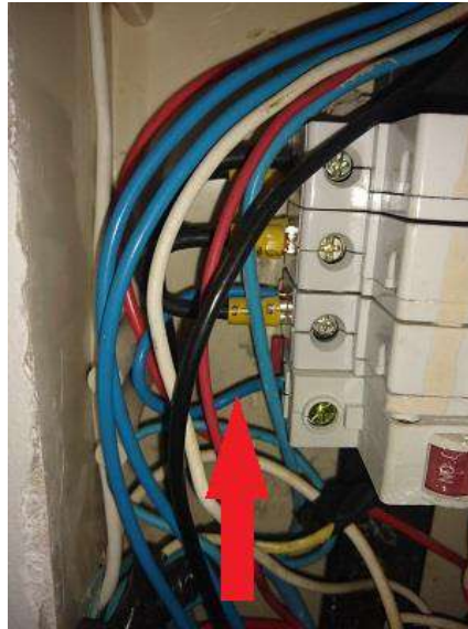
Figura 25 – Fio com isolamento na cor azul sendo utilizado em um circuito de fase.
