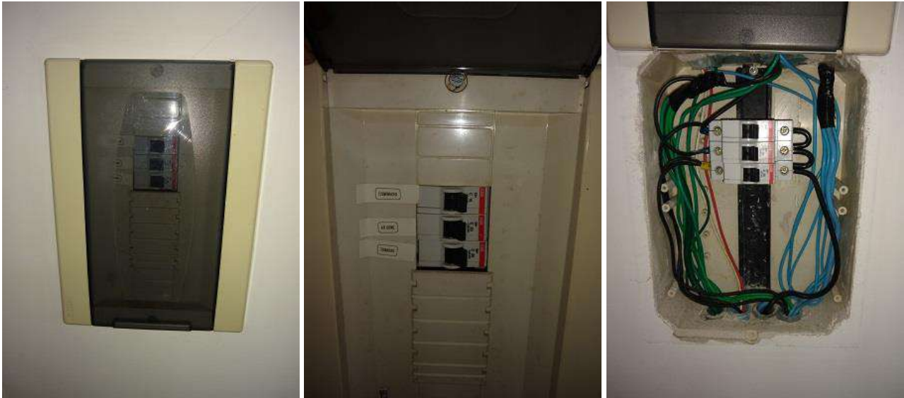
Figura 15 – Quadro de distribuição QD11 – Pavimento 1º tipo.
