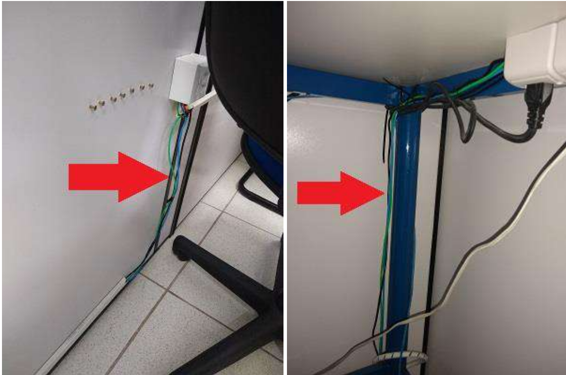
Figura 53 – Fiação exposta sem proteção mecânica.
