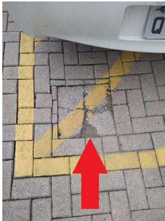
Figura 2 – Caixa de inspeção com a tampa danificada.
