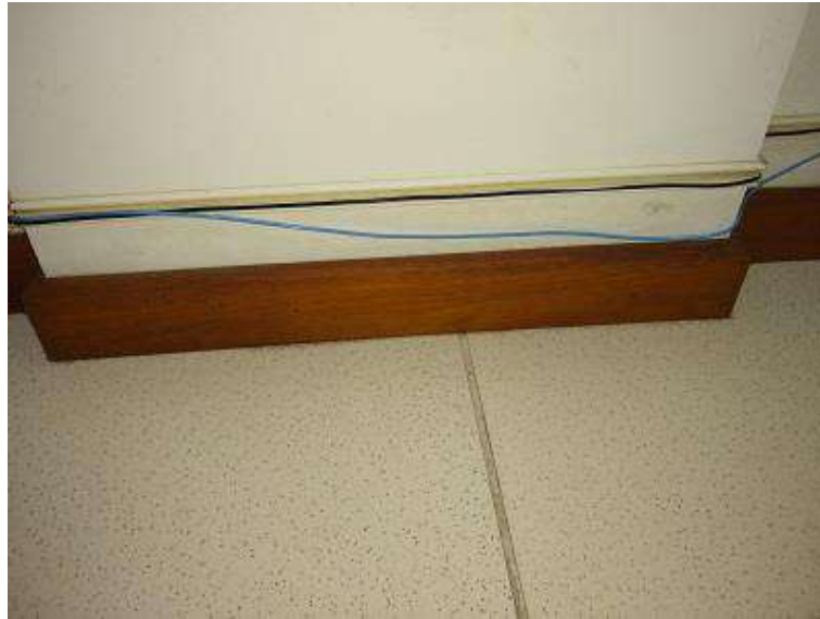
Figura 50 – Canaleta aberta com fiação exposta.
