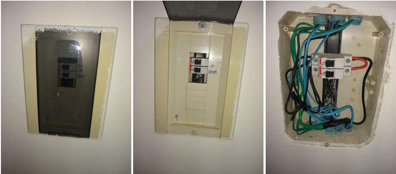
Figura 33 – Quadro de distribuição QD19 – Pavimento 3º tipo.
