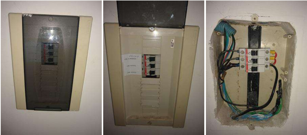
Figura 28 – Quadro de distribuição QD16 – Pavimento 2º tipo.
