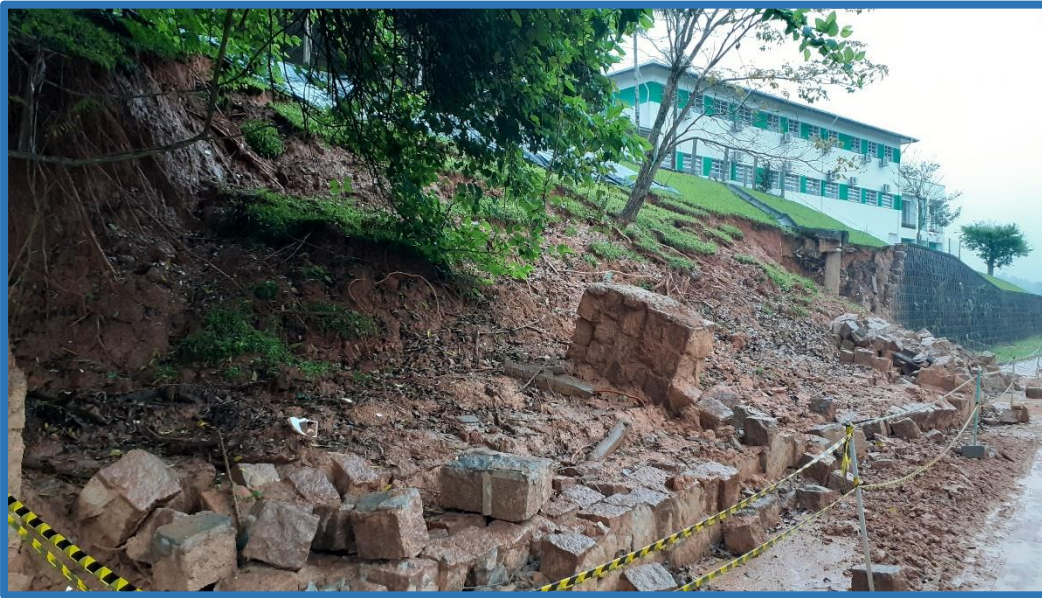
Muro em alvenaria de pedra colapsado.
