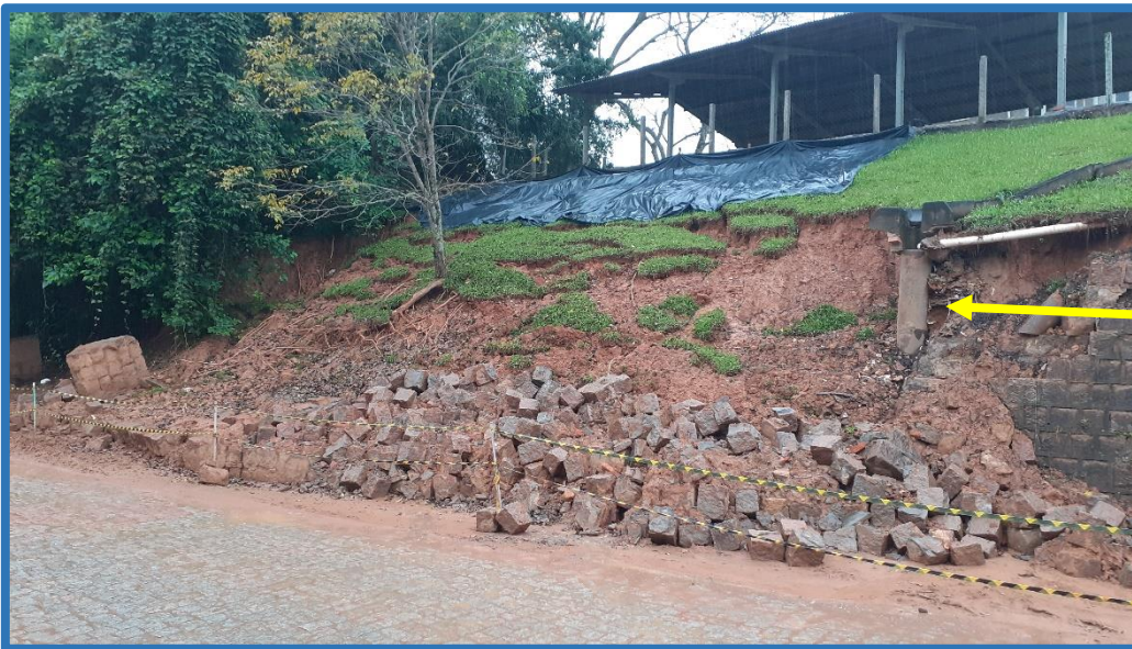
Muro em alvenaria de pedra colapsado.
