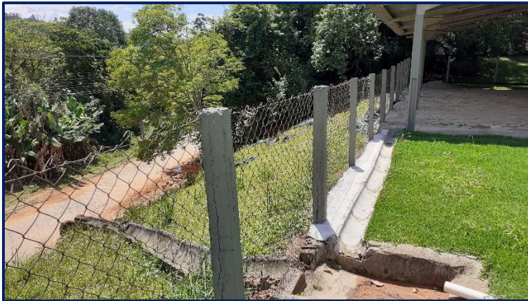
Calha sem operacionalidade – a água vertia pelos bordos.
