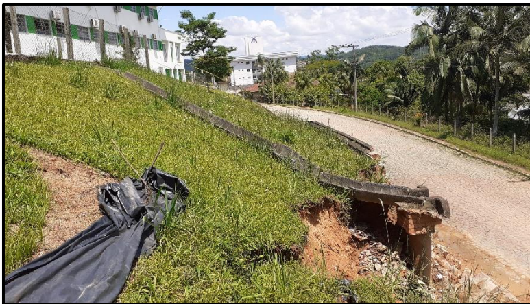
Calha sem operacionalidade – a água não entrava na caixa coletora.
